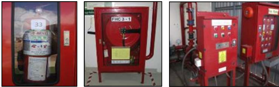
รูปที่ ๓-๑๘ ติดตั้งอุปกรณ์ระงับเหตุฉุกเฉิน พร้อมทั้งตรวจสอบสภาพความพร้อมใช้งานอย่างสม่ำเสมอ
