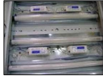
รูปที่ ๓-๕ ติดตั้งบัลลาสต์อิเล็กทรอนิกส์
